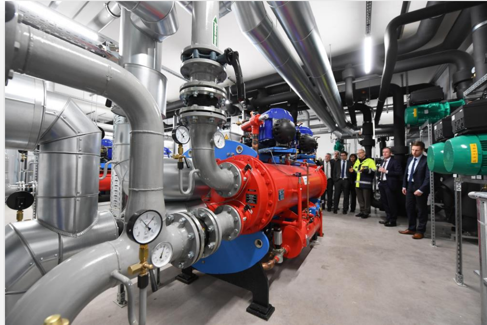
Wärmepumpe 500 kW th
