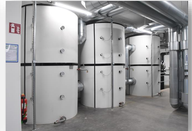
Speicher für Kalt- und Heizwasser
