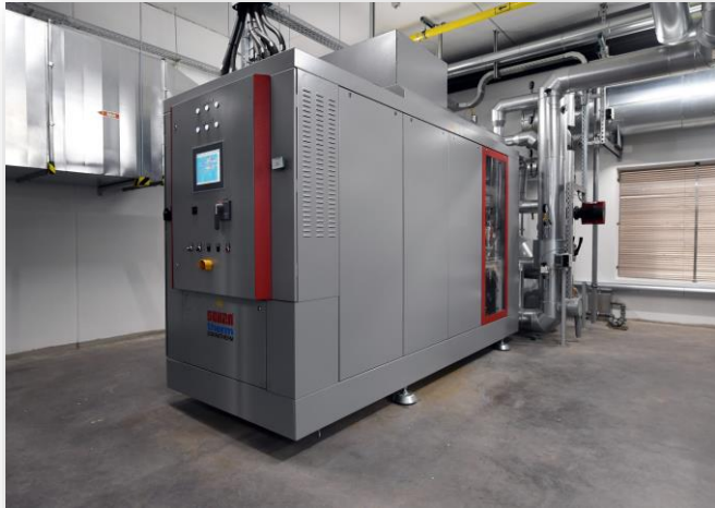
BHKW 337 kW el / 455 kW th
