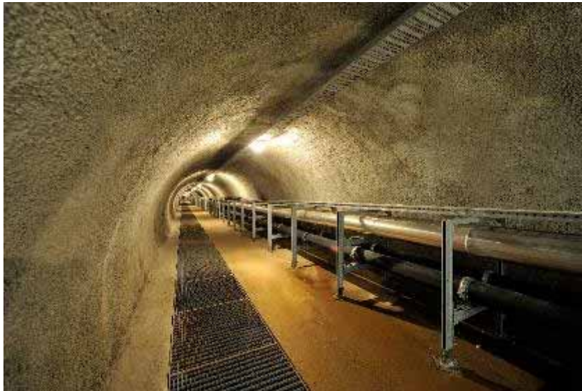
Quelle: Dr. Eicher+Pauli AG, Stollen Casion Aarau (WV aus Grundwasser)
